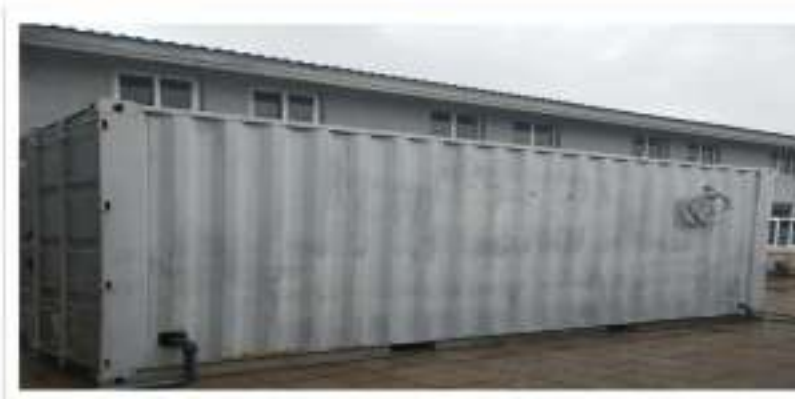
Островная система аварийного водоснабжения
